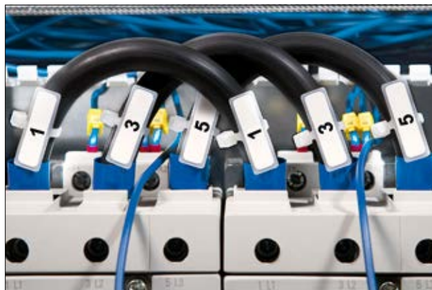
IT Kabelbinder – ein Arbeitsgang mit doppeltem Nutzen.
