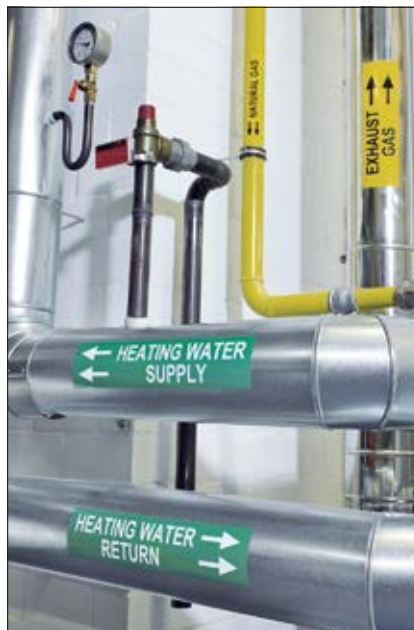
Eindeutig lesbare Beschriftung von Rohren und Leitungen mit Helatag-Etiketten.
