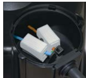
HelaCon Lux verbunden mit der Stromversorgung.
